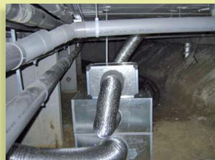
2 L'installation comporte 8 tubes de 40 mètres de long à 1,6 mètres de profondeur
